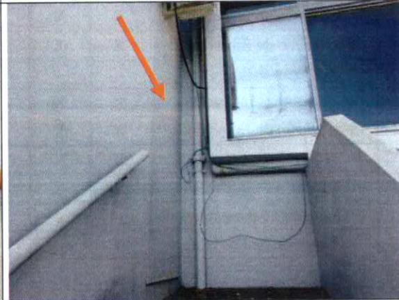
Figura 48: porta de saída da escada à prova de fumaça na área externa foi lacrada com alvenaria
